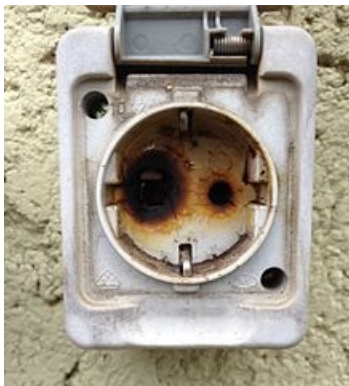
Presa Schuko danneggiata in seguito all'erogazione di eccessiva corrente
