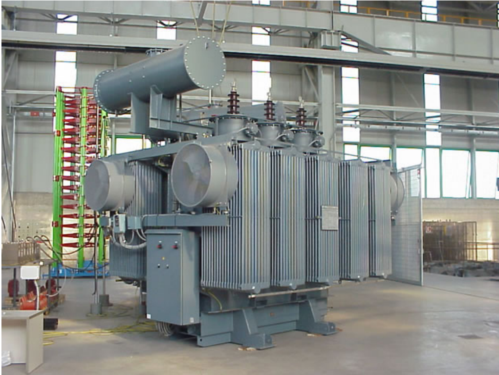
Trasformatore di distribuzione - TES
