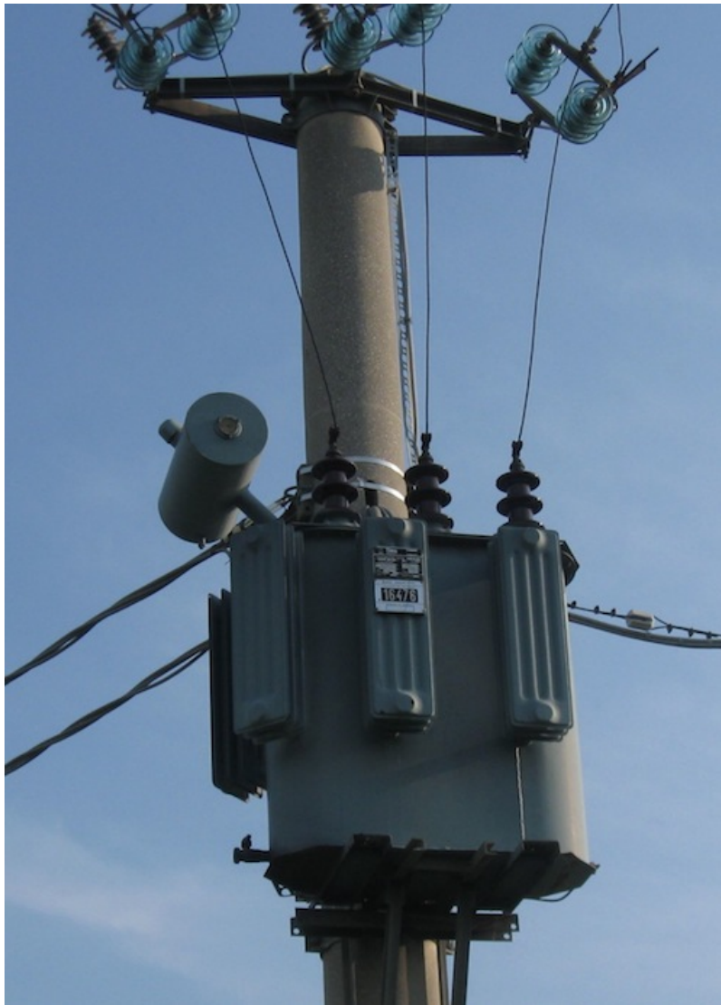
trasformatore da palo in via Budel del Lovo (PD)
