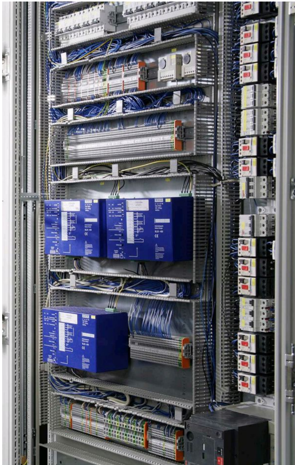
quadro generale di comando
