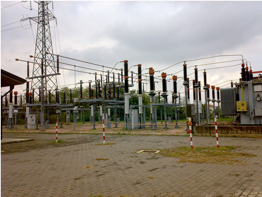
Stalli composti da sbarre, sezionatori, interruttori, TA, TV
