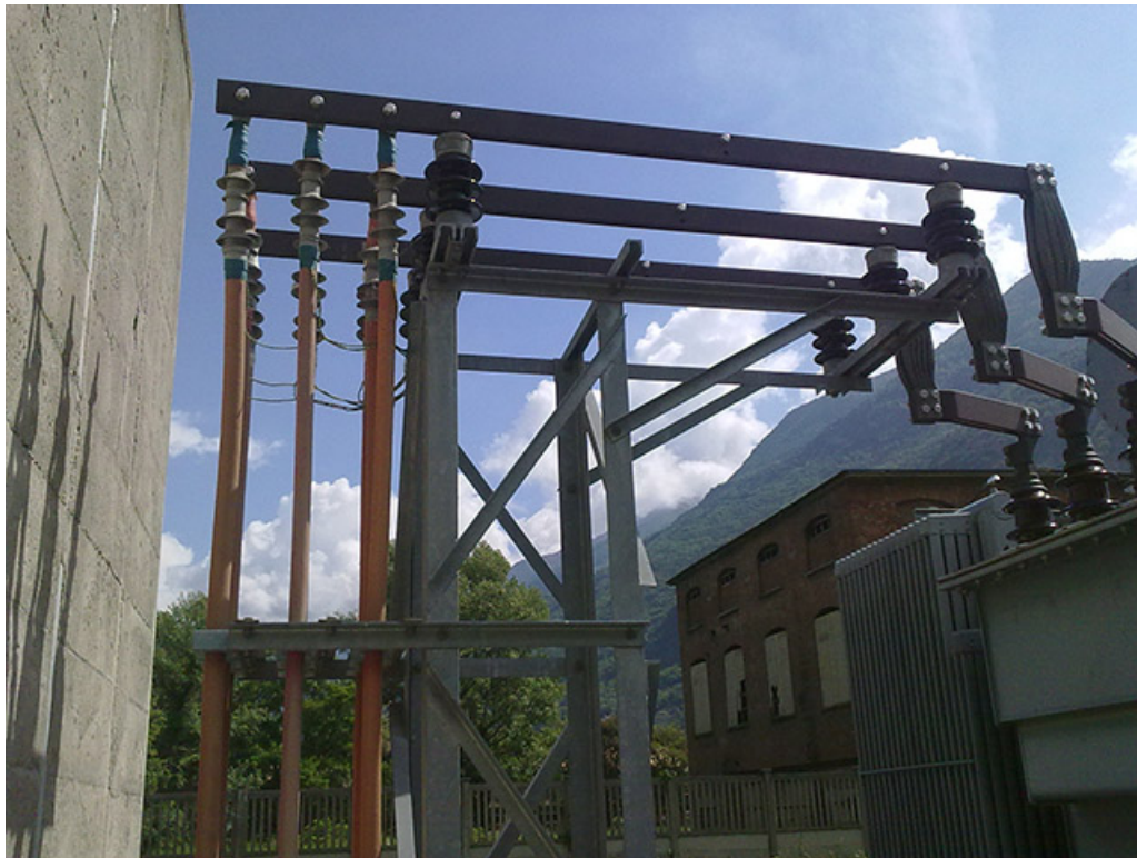
Dettagli del castelletto MT con partenza cavi
