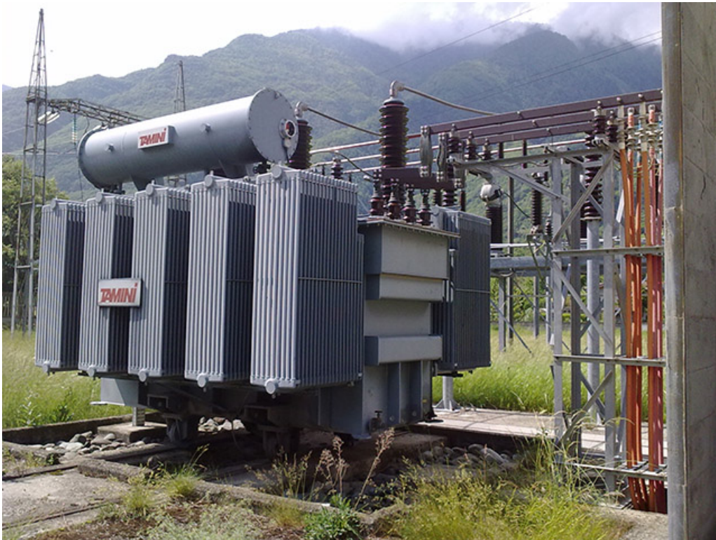
Trafo Tamini con primario AT e castelletto MT in una sottostazione in provincia di AO
