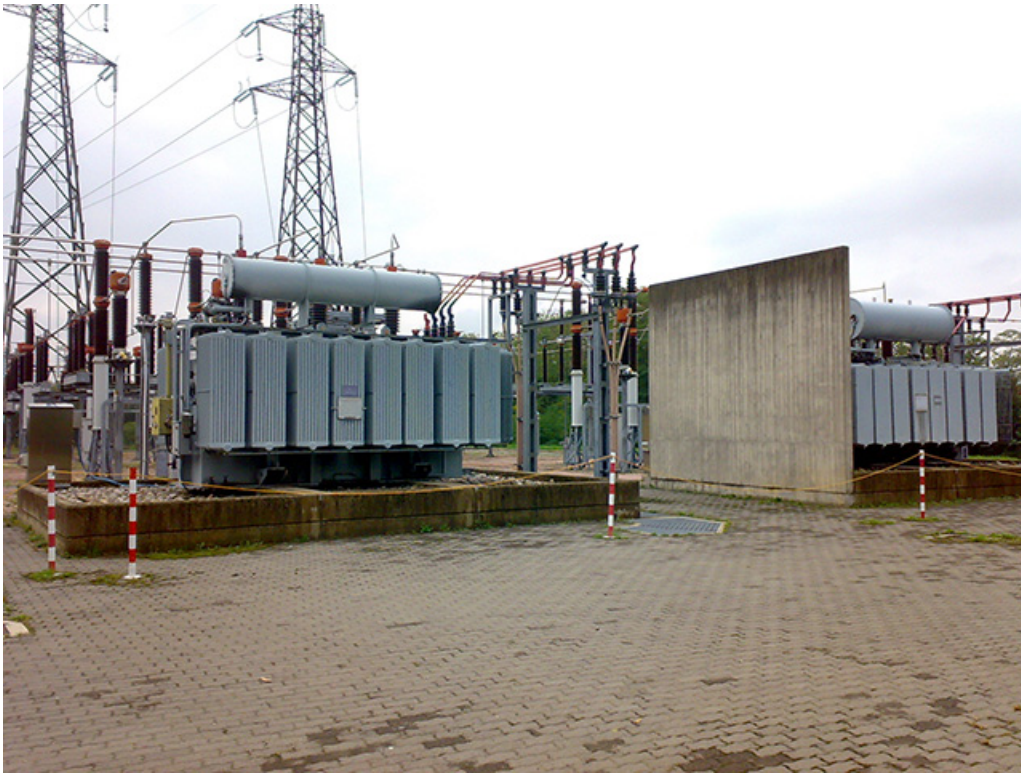
Due trafi nella cabina primaria di Carugo (CO)
