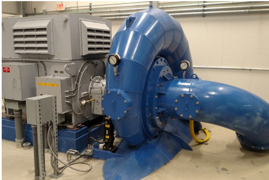
Turbina Idroelettrica ad asse orizzontale
