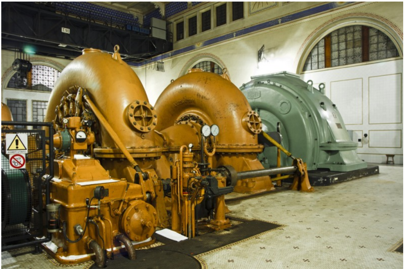
FLICKR_Centrale Idroelettrica Nove.jpg
