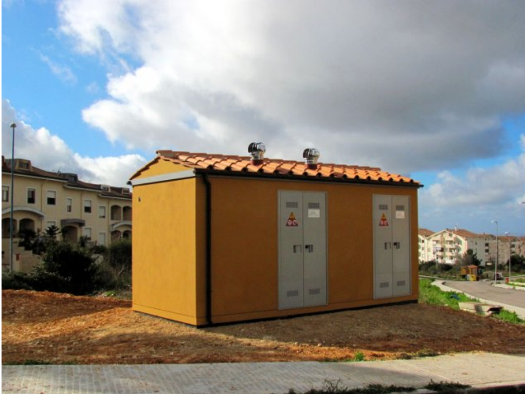
Cabina Distribuzione SipaSpa
