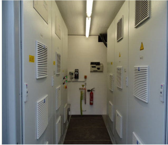
Vista interna di uno STATCOM di Freqcon
